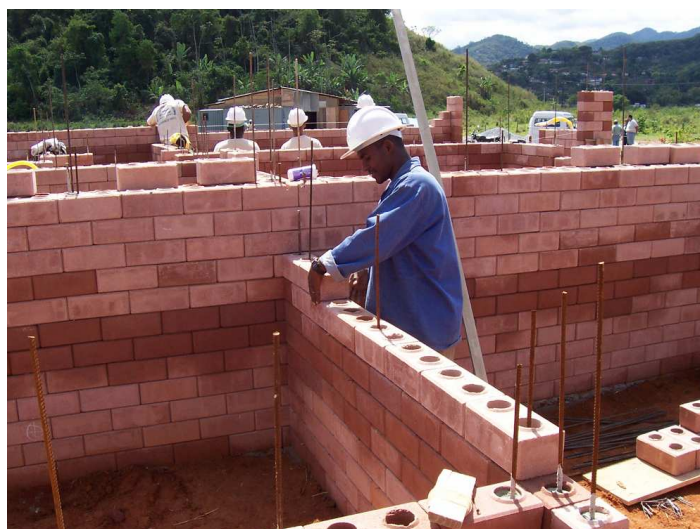
Construção de casas com tijolos de solo-cimento – Xerém (RJ) – 2005. Foto do autor
